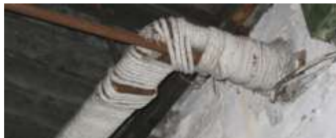
Typischer Fund: schwach gebundener Asbest bei Entkernungsarbeiten
