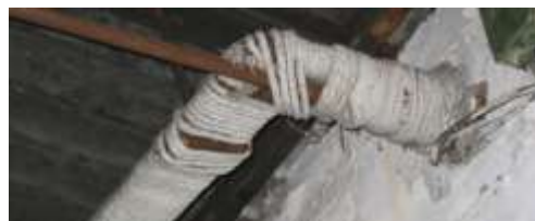
Typischer Fund: Asbest bei Entkernungsarbeiten
